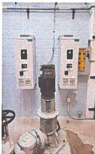
Non Pot VFD install
